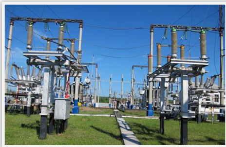
ТП 110 кВ «Чукша», ОРУ 110 кВ
