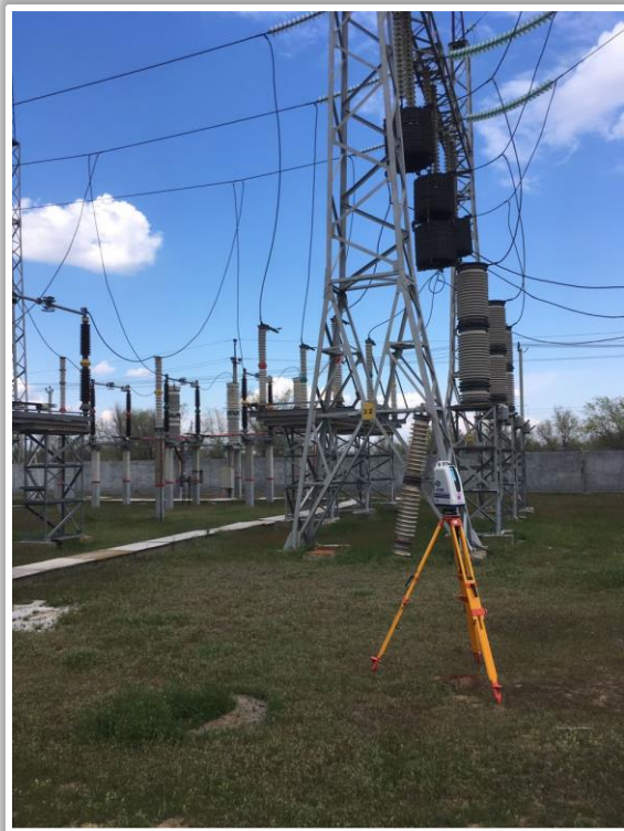
Тяговая подстанция «Аксарайская», Приволжская железная дорога
