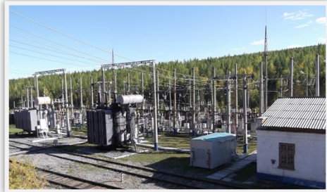
ТП 110 кВ «Чёрная»
