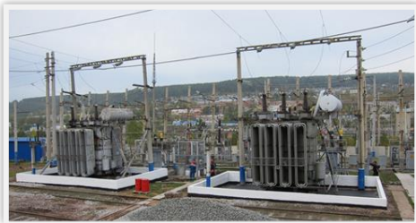
ТП 110 кВ «Коршуниха», Силовые трансформаторы
