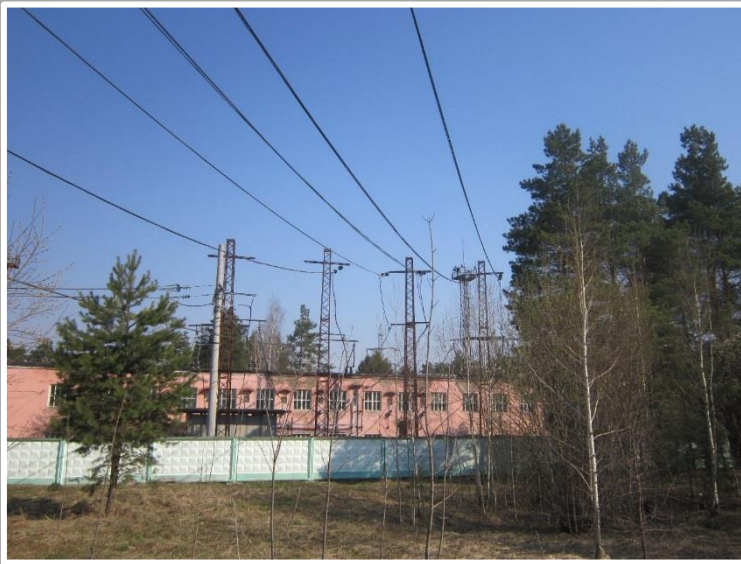
Тяговая подстанция «Луховицы», Московская железная дорога
