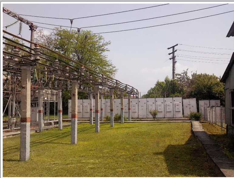
Тяговая подстанция «Беслан», Северо-Кавказская железная дорога
